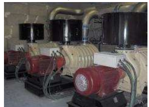
V-CENTRIF: Station d'épuration de Isle sur la Sorgue
