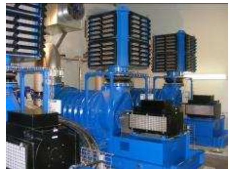
V-CENTRIF: Station d'épuration de Brive La Gaillarde
